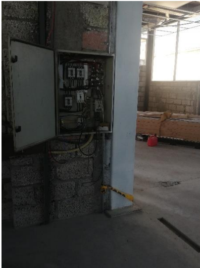
Foto 3: Instalación de voltaje
