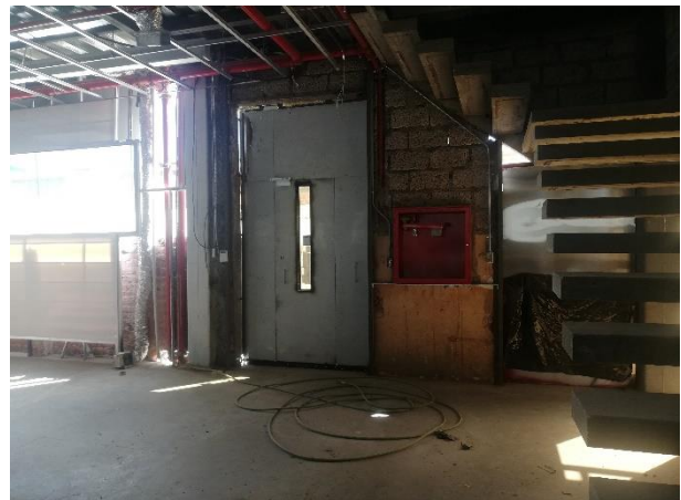
Foto 16: Salidas de Emergencia
