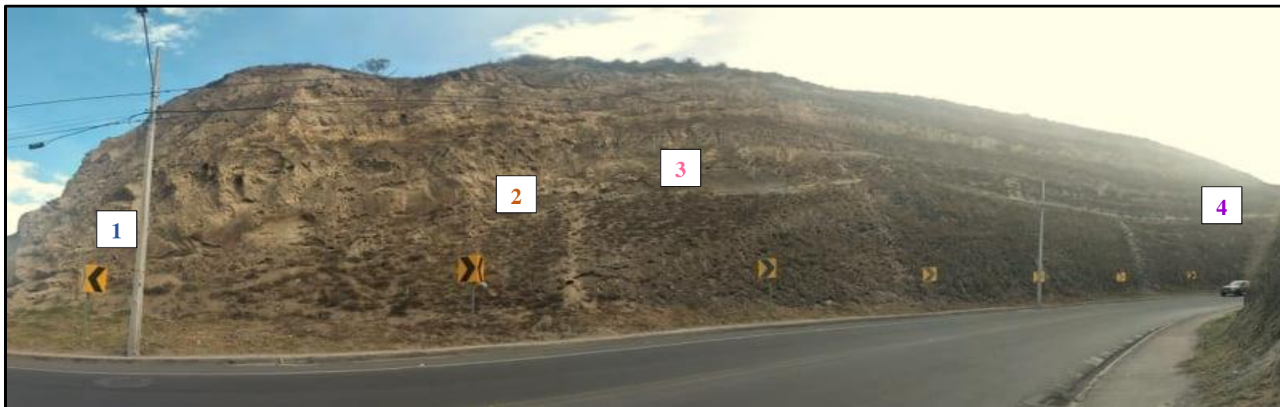
FIGURA 32. Perfil estratigráfico real de la Curva Brava con las calicatas
