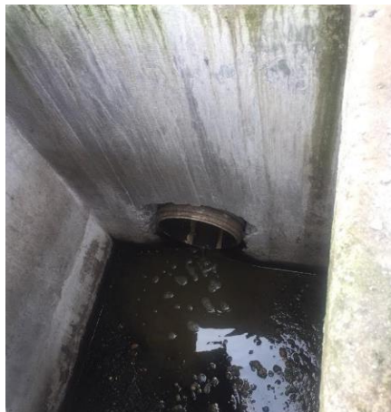
Figura 8. Tanque repartidor PTAR
