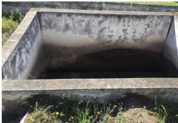
Figura 11. Lecho de secado de lodos PTAR
