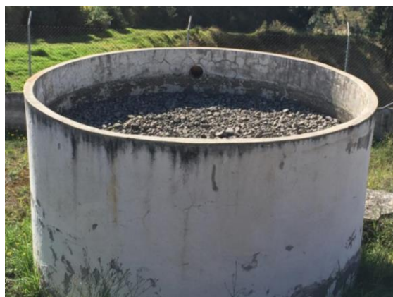
Figura 10. Filtro anaerobio de flujo ascendente PTAR
