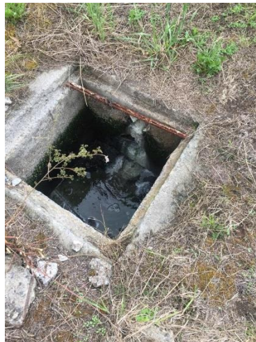
Figura 28. Caja de revisión salida PTAR
