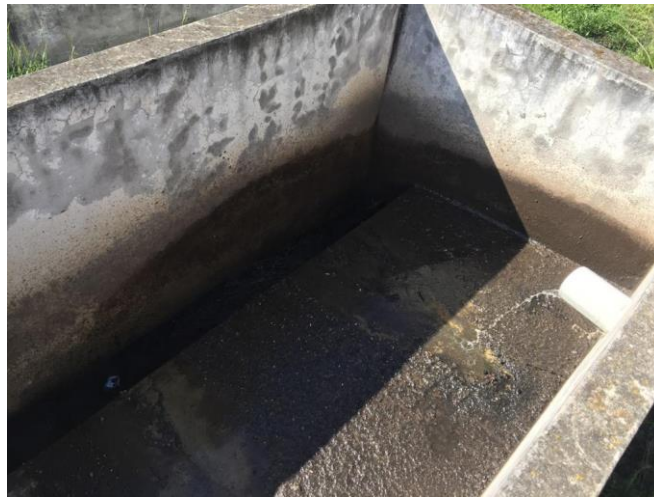
Figura 30. Lecho de secado de lodos
