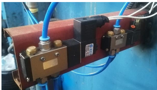
Figura. 27: Solenoides neumáticos instalados [Autor].
