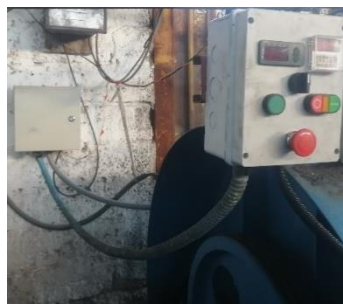
Figura. 28: Tableros de mandos y control [Autor].
