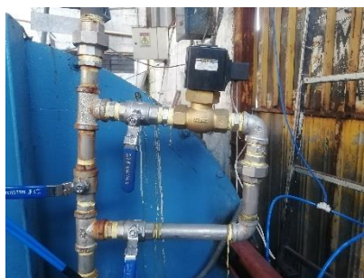
Figura. 26: Válvula de vapor instalada [Autor].
