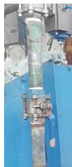
Figura. 24: Válvula neumática instalada [Autor].
