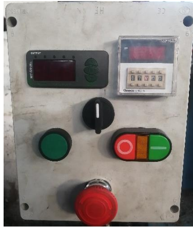
Figura. 21: Tablero de mando armado [Autor].
