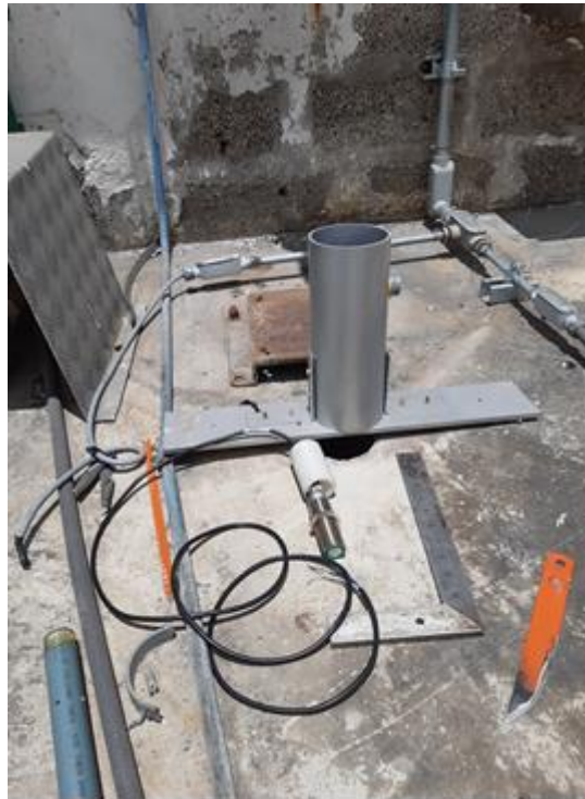
Figura 71: Conexión sensores de nivel.
