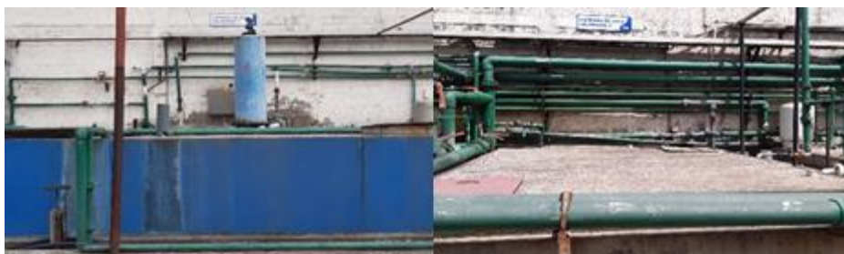
Figura 15: Cisternas de Agua Ablandada 1 y Agua Ablandada 2
