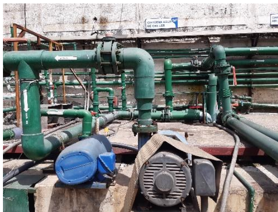
Figura 19: Cisterna de Chiller
