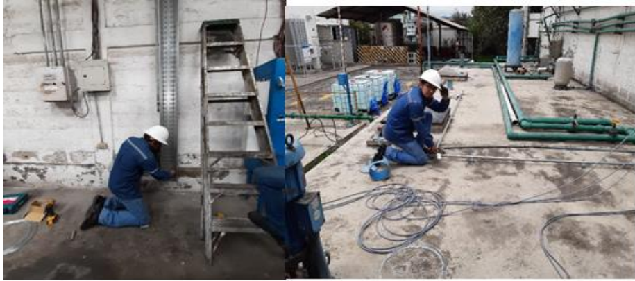
Figura 70: Ruteo de Cables.
