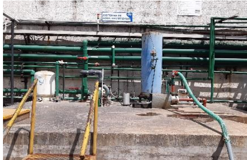
Figura 20: Cisterna de Agua Osmotizada.
