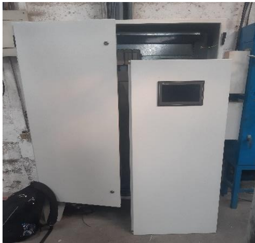
Figura 45: Montaje de la pantalla DELTA-DOP en el tablero de control.
