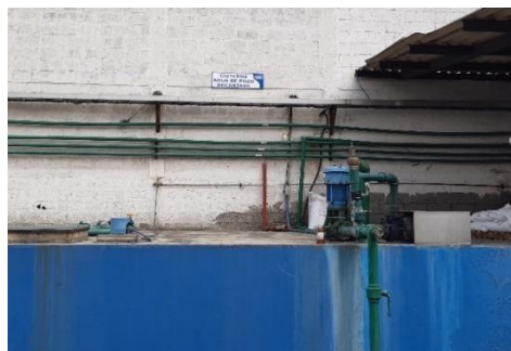
Figura 17: Cisterna de Agua Decantada
