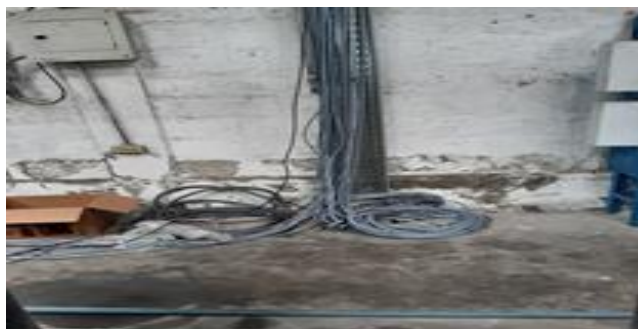
Figura 42: Ruteo de Cables de todas las cisternas de proceso.
