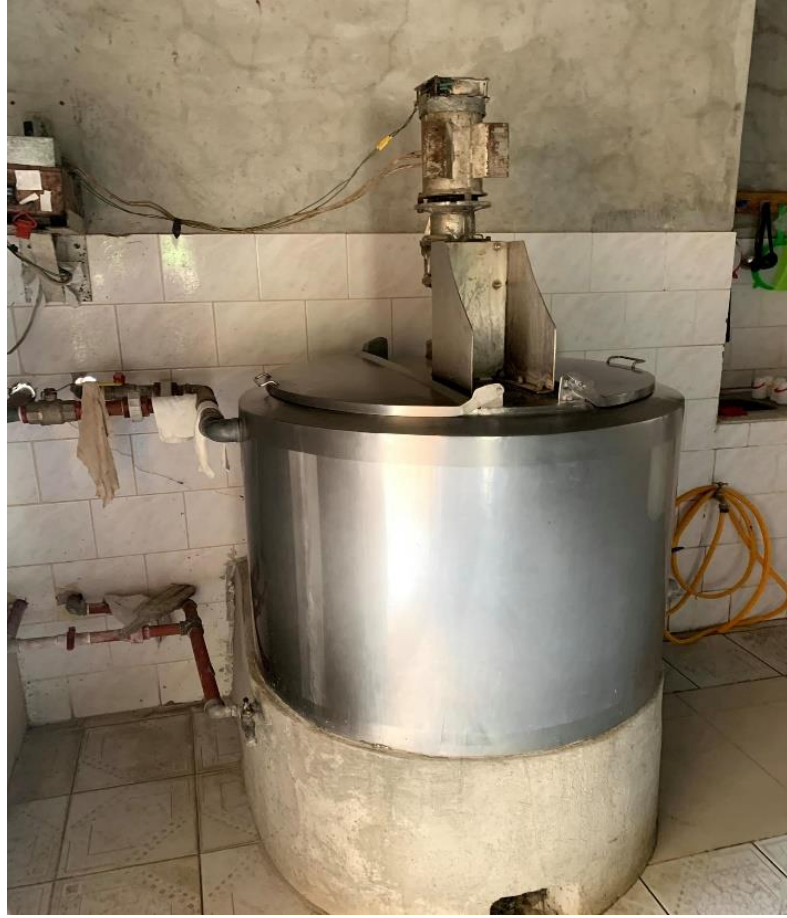
Figura 25 Tanque de Mezclado y Pasterización.
