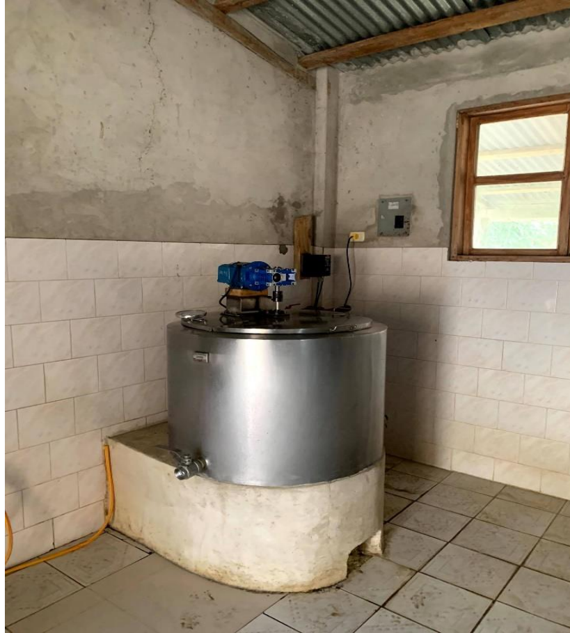
Figura 27 Tanque de enfriamiento
