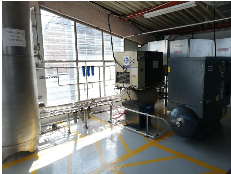
Figura 4. Equipos y componentes del sistema de aire comprimido instalado.
