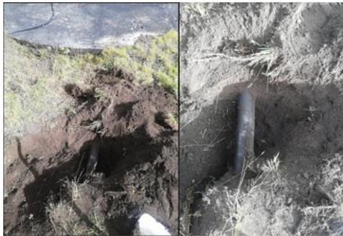
Figura 30. Tubería principal de ingreso al tanque reservorio.
