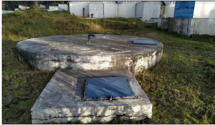
Figura 29. Tanque principal de distribución de agua potable
