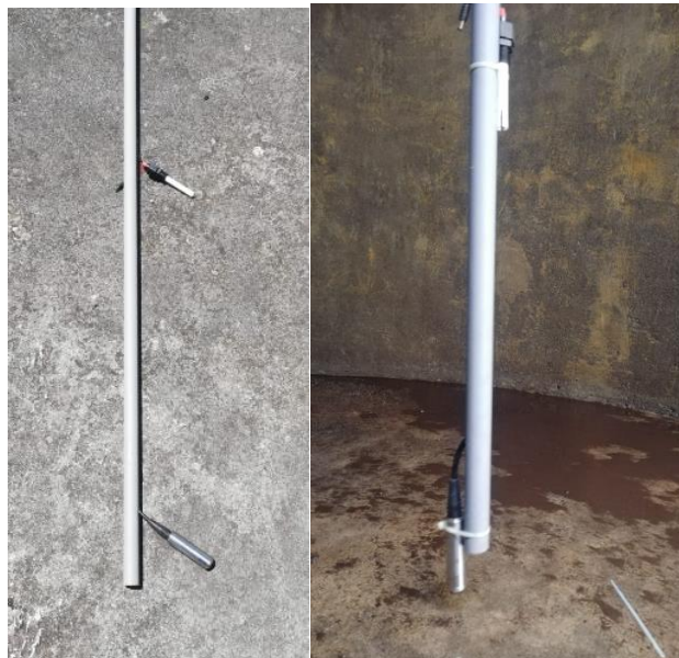
Figura 34. Instalación de los sensores de nivel, pH, temperatura.
