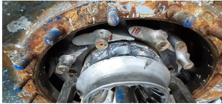
Figura 7. Distribuidor de la máquina de generación [Autor].
