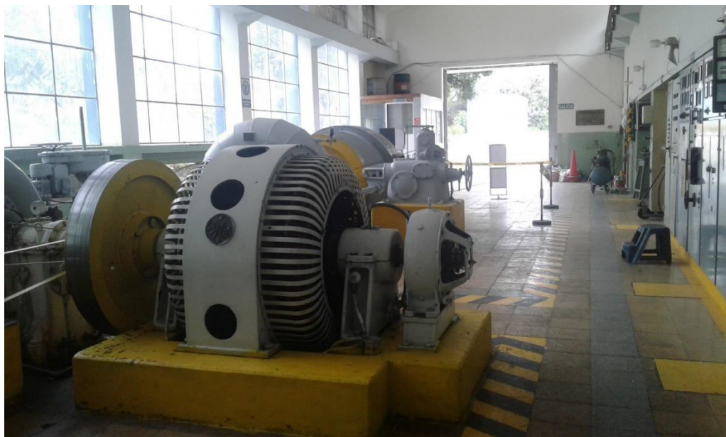
Figura 5. Generadores tipo Francis de la central La Península. [Autor]
