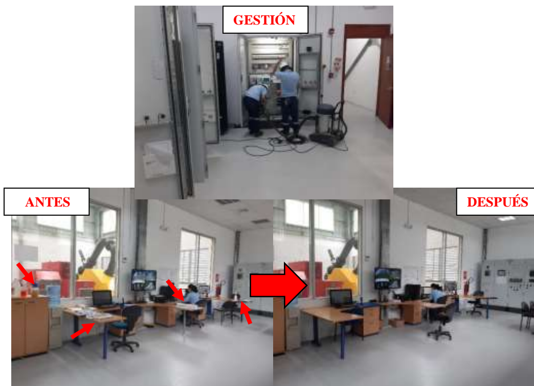
Figura 24: Gestión realizada en el cuarto de control de casa de máquinas, Autor
