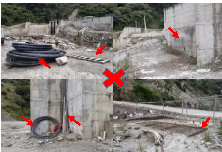
Figura 14: Identificación de elementos sistema de captación, Autor.
