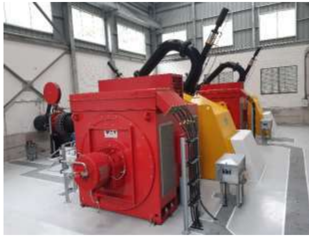
Figura 9: Turbinas Pelton de 5MW HRVC, Autor.
