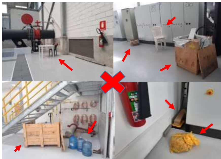
Figura 13: Identificación de elementos en casa de máquinas, Autor.
