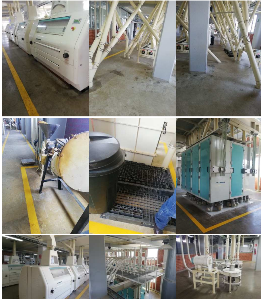
Figura 41.- Evidencia fotografía de SEITON en el subproceso de molienda Fuente: Autor
