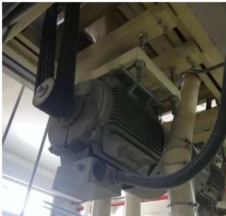
Figura 52.- Motor eléctrico del Banco B1 [M401] Fuente: Autor
