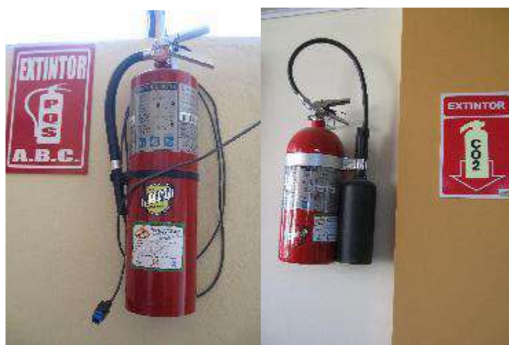
Figura 32: Señalética de seguridad.
