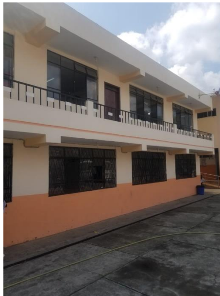
Gráfico 19 Estado actual del edificio de aulas de la Unidad Educativa Santo Domingo de Guzmán
