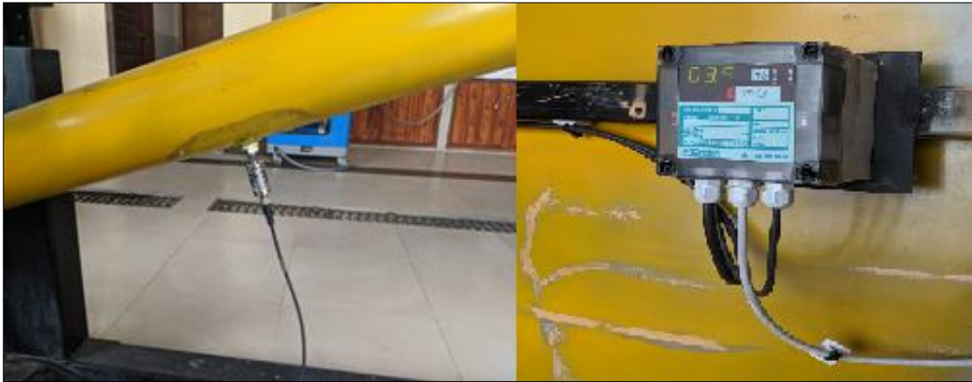
Figura 11.- Medidor de caudal
