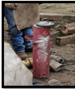
Figura 21. Termo de almacenamiento de electrodos.
