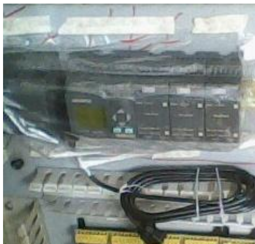
Fig. 6.9 PLC marca SIEMENS
