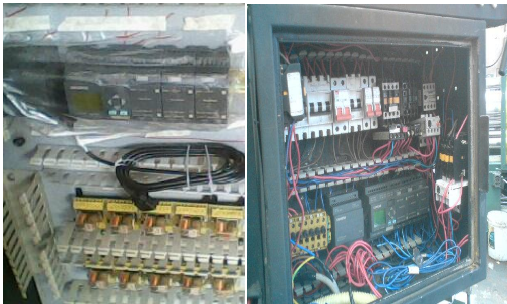
Fig. 2.6. Tableros de control
