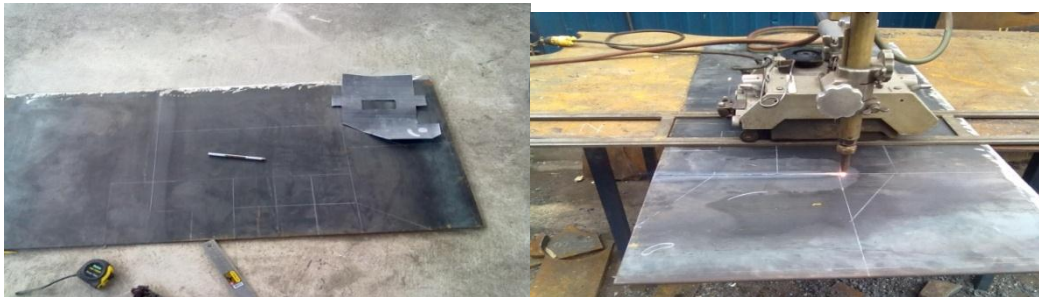
Figura 73. Rayado placa metálica.
