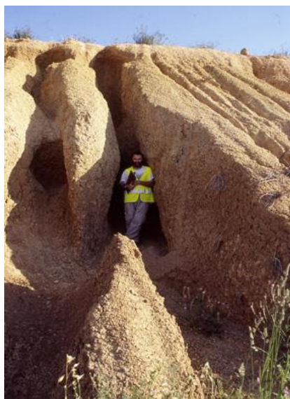
Grafico No 12: Falla por erosión en cárcavas Fuente: Suárez, Jaime, Análisis Geotécnico
