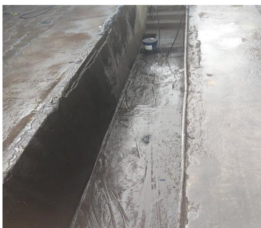
Figura 18. Rampa de Lavado de Chasis y Carrocería. Fuente: Autor
