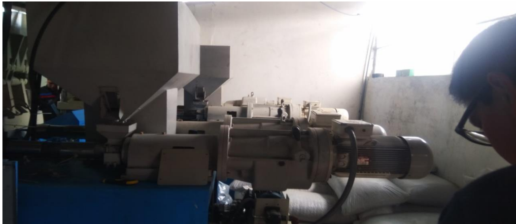
Figura 4.- Área de máquinas.
