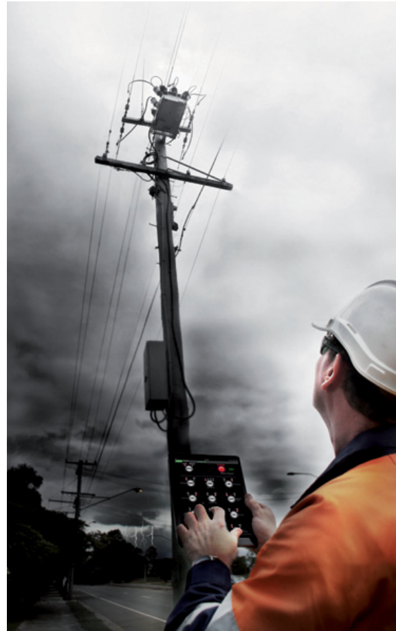
APLICACIÓN REMOTA DEL RECONECTOR DE NOJA POWER
