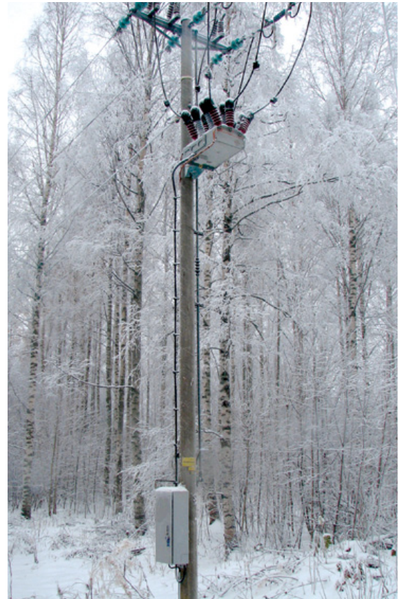
Reconector OSM y Control RC y Cubículo de Comunicaciones
