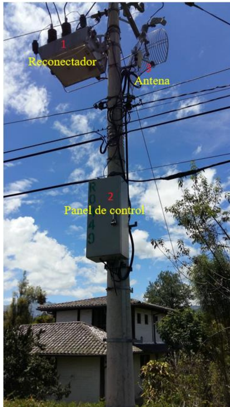
Fig. 6-18: Reconectador R0449 con su sistema de comunicación
