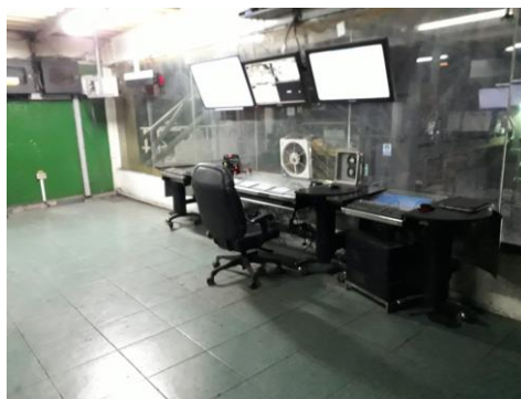
Fig. 57 Tablero de mando de máquina de solidificación continua del acero.
