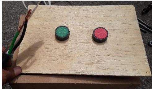
Imagen 25. Cuadro de encendido del motor de la bomba.
