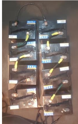
Figura 4. 15 Conexión del banco de baterías
