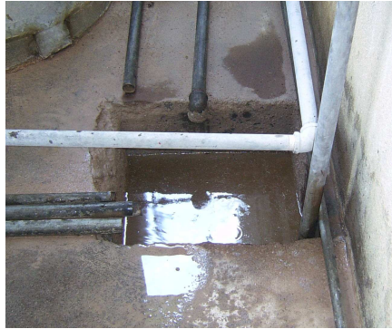
Fig. 18 Drenaje de los lodos
