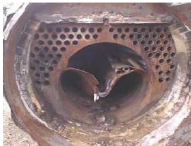
Fig. 23 Fallas en calderos Fuente: Internet
