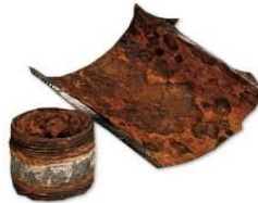
Fig. 10 Corrosión de tubos
