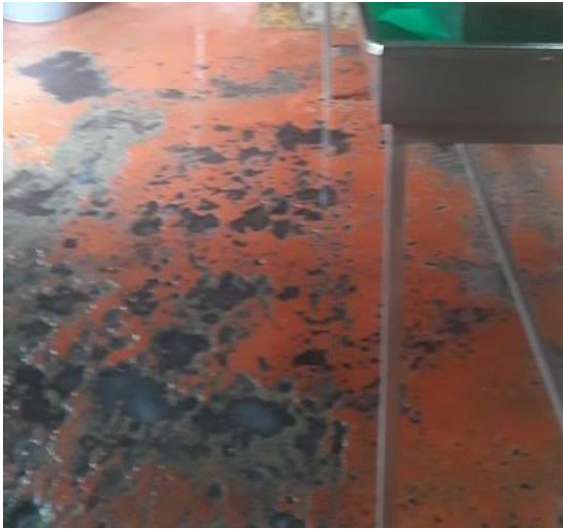
ANTES Pisos agrietados
