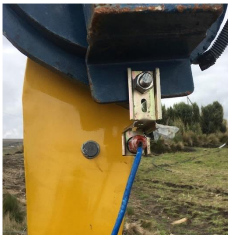
Figura 39. Instalación de los imanes para la medición de la velocidad de rotación del rotor [Autor].
