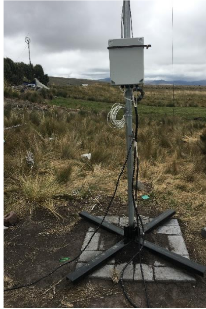
Base del tablero de control de la torre de muestreo
