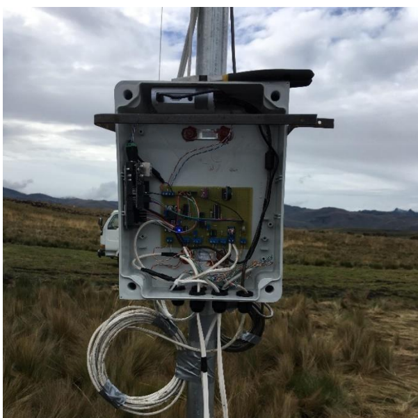
Figura 31. Instalación del Datalogger y los sensores [Autor].
