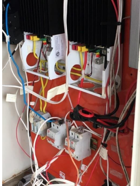
Figura 35. Cableado del sistema de control en mal estado [Autor].
