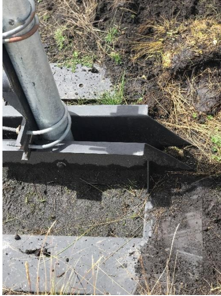
Figura 37. Base del aerogenerador enterrada causado por el trabajo de la misma y las condiciones climáticas [Autor].
