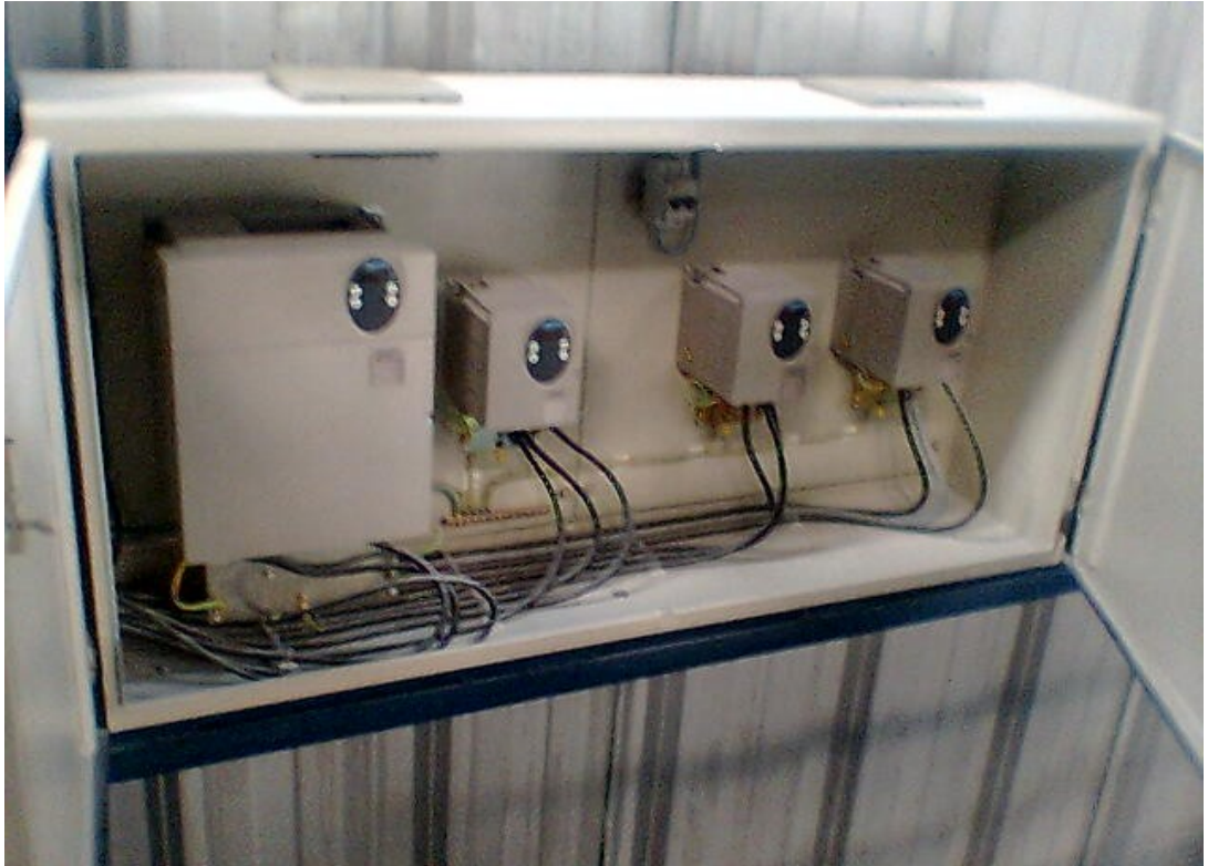
Fig. 27 Variadores de frecuencia instalados
