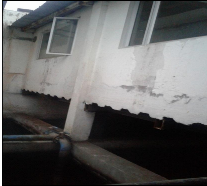
Fig. 17 Laboratorio de la PTAR sobre TK1- tanque de homogenización
