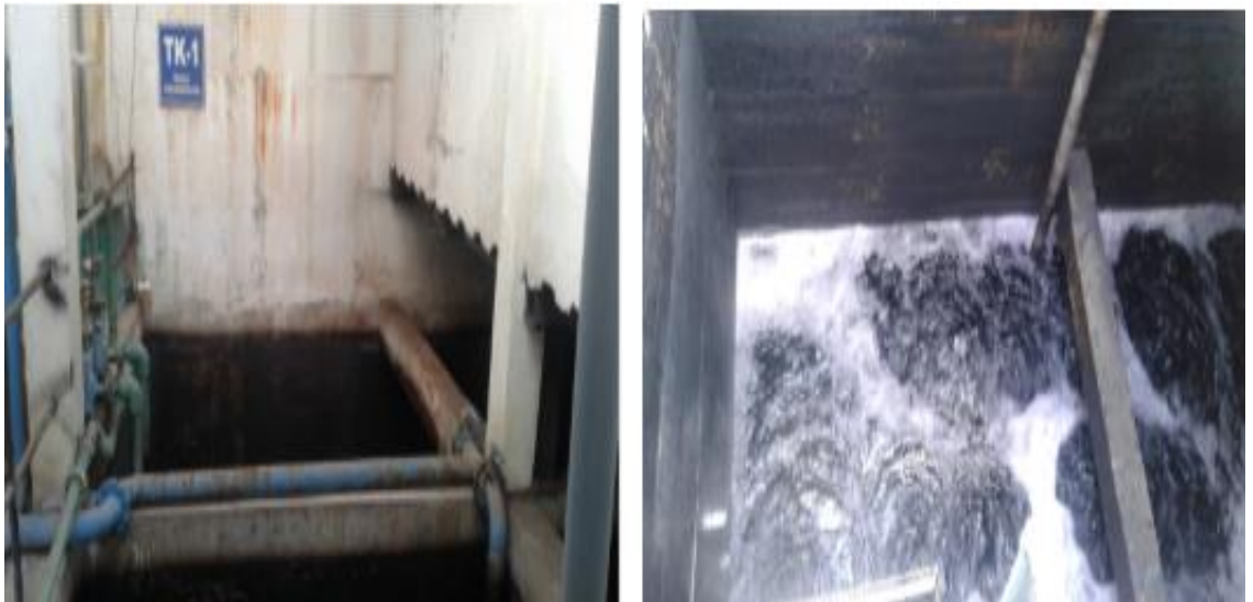
Fig. 7 Tanque de Homogenización
