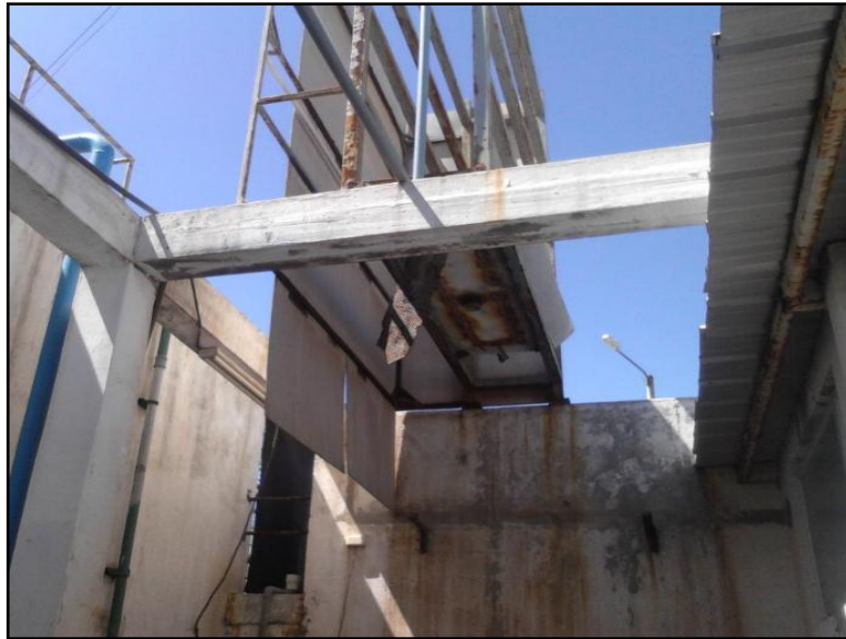
Fig. 15 Oxido de la estructura metálica de las instalaciones en la PTAR
