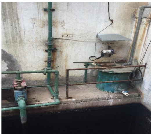
Fig. 8 Tubería que conecta el tanque de homogenización y el tanque biológico.
