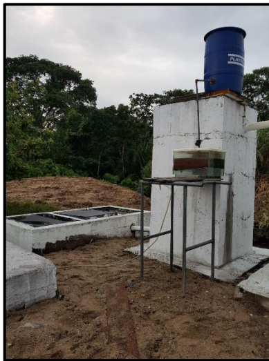
Figura N° 6 Filtro instalado en la industria.
