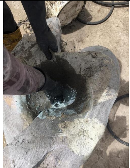
Imagen 23. Proceso de pre filtración antes del llenado del tanque de abastecimiento
