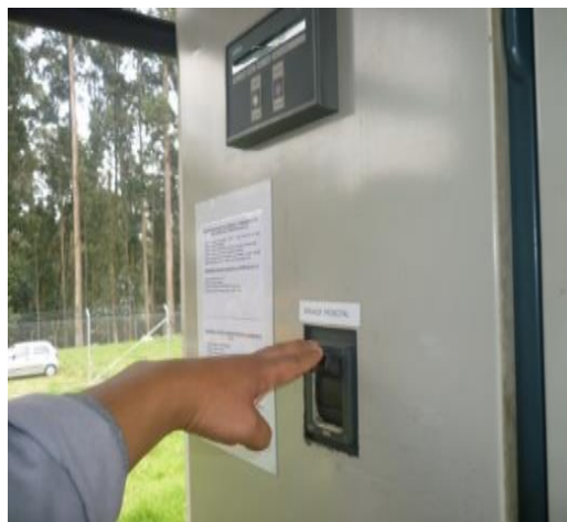
Figura N° 35 Corte de energía tablero 220 N° 1
