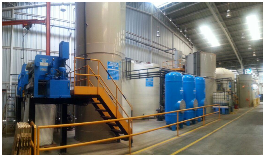
Figura N° 12 Planta de tratamiento de cromado
