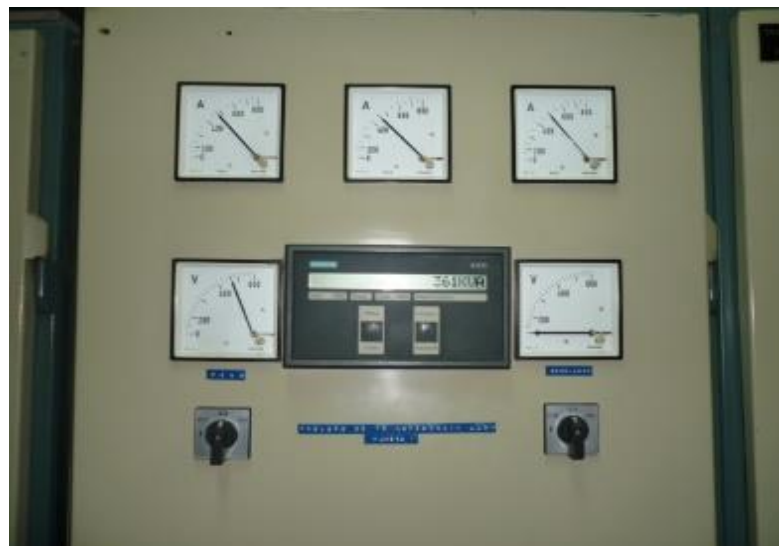
Figura N° 34 Tableros de Transferencia N° 1
