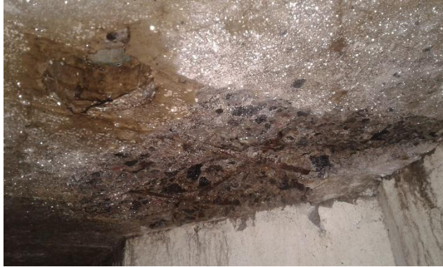
4. Filtraciones en la losa del tanque de captación
