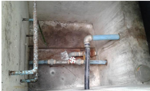
2. Accesorios del tanque de captación
