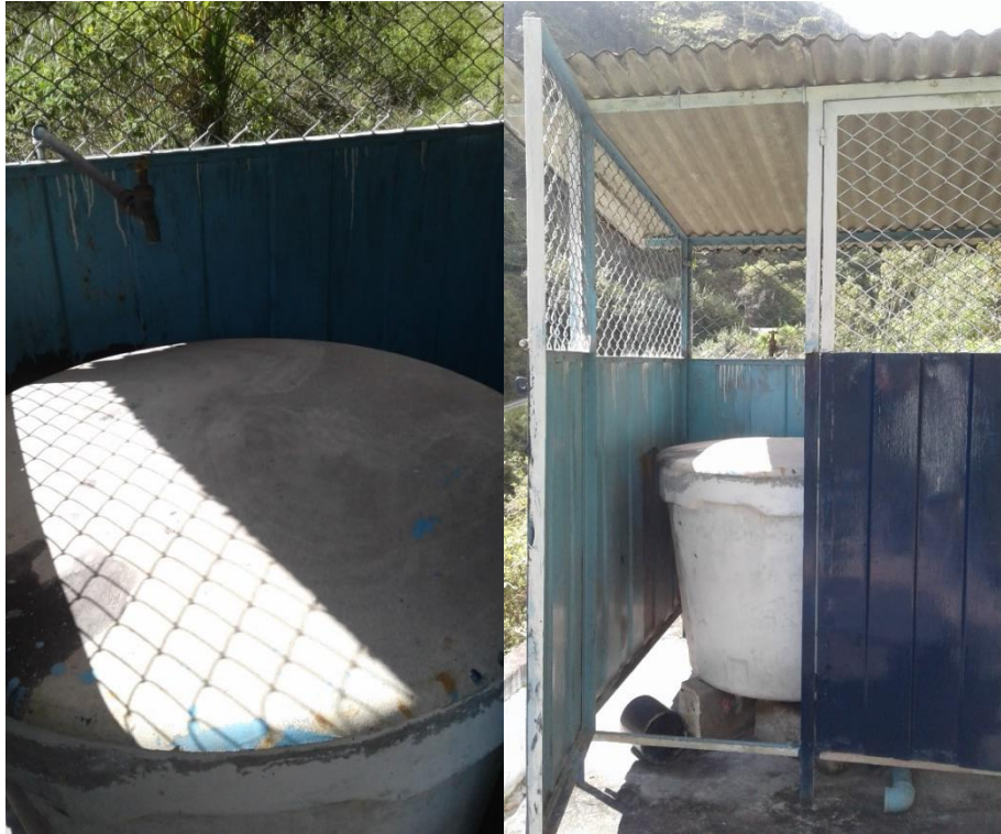
9. Caseta de cloración y tanque para la desinfección
