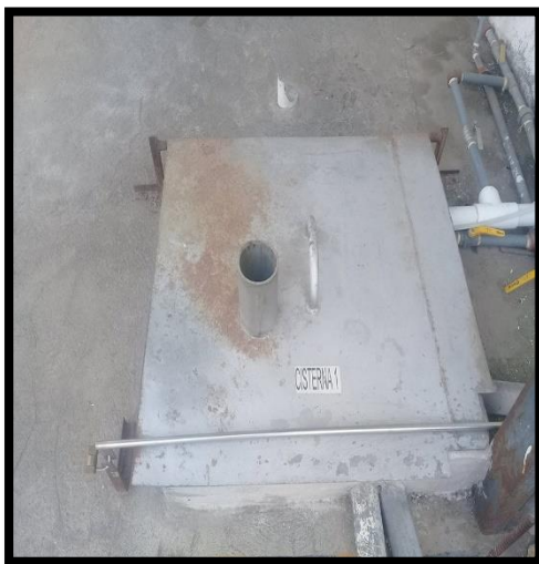
Imagen 9.- Cisterna donde se almacena el agua que se utiliza en la fábrica
