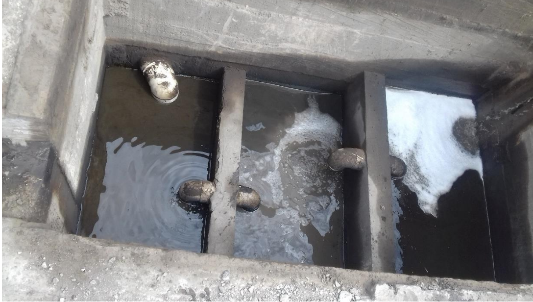
Imagen 5. Pozos de trampas de grasas
