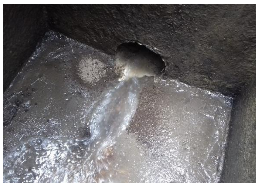
Caja de revisión para tomar datos de caudal de salida
