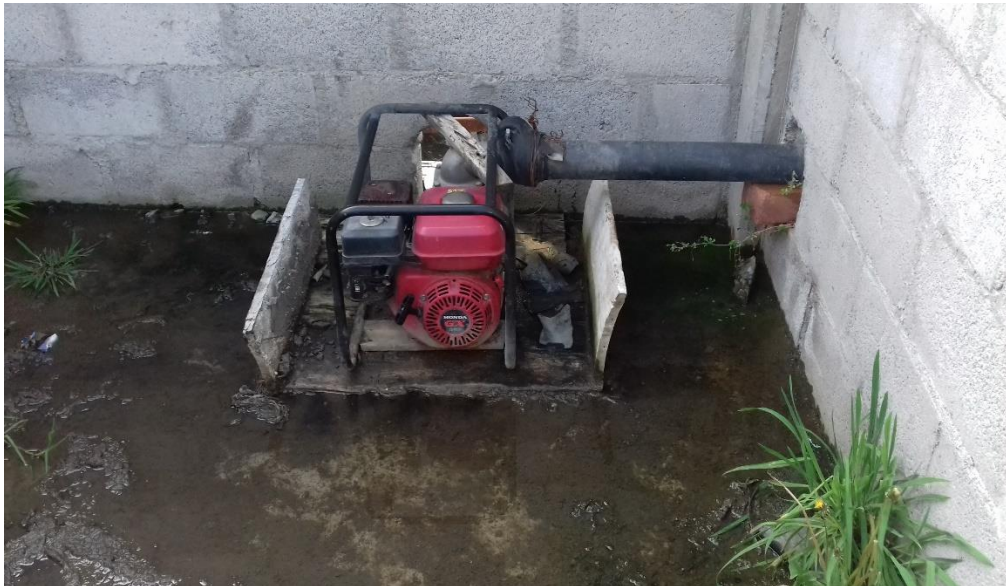
Imagen 3. Bomba abastecedora de agua hacia el segundo tanque
