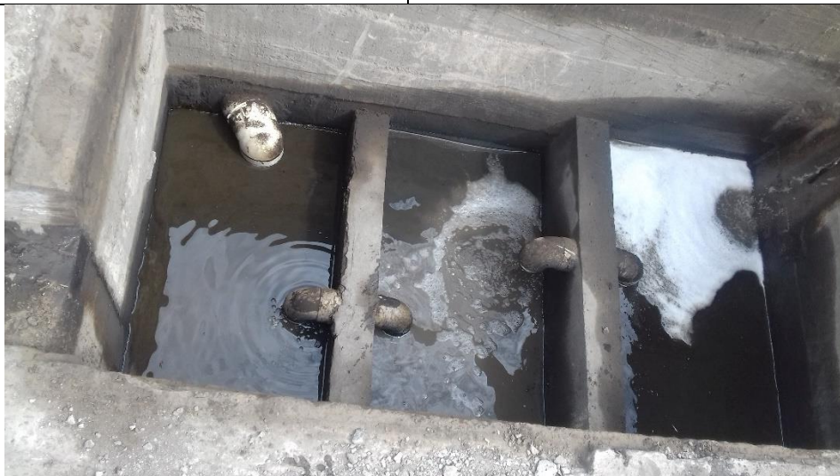
Pozos de trampa de grasas y punto de toma de agua residual para filtro
