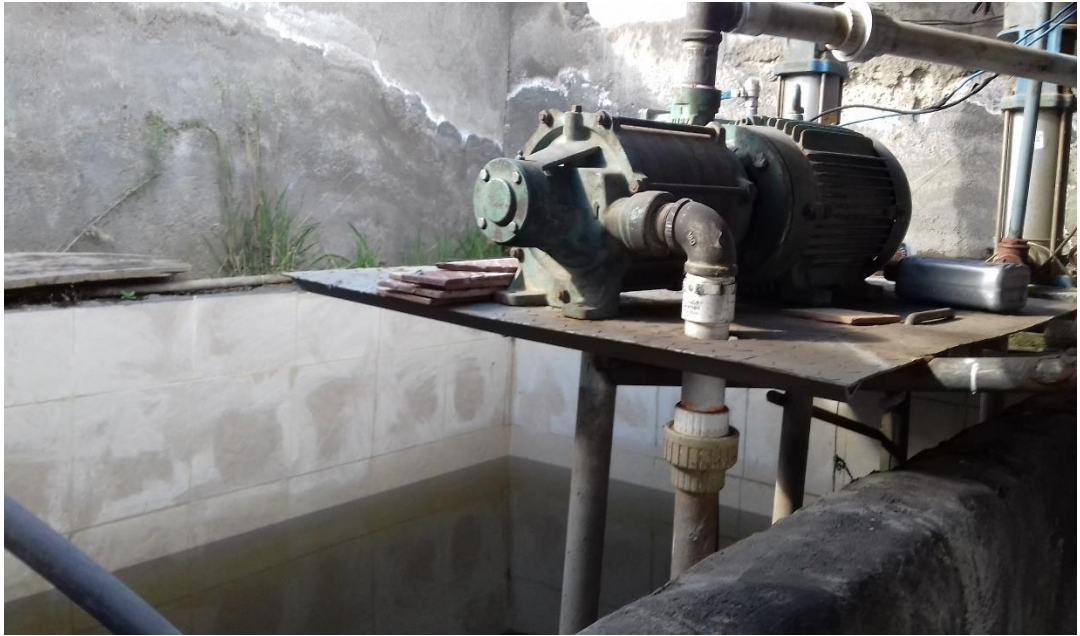
Imagen 4. Tanque de almacenamiento de menor capacidad y bomba de presión
