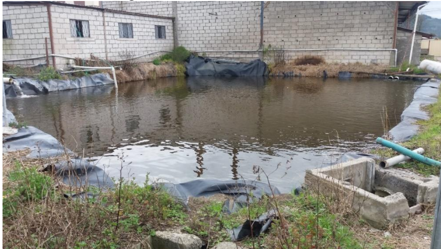
Fotografía 2: Cisterna 2 de la Industria
