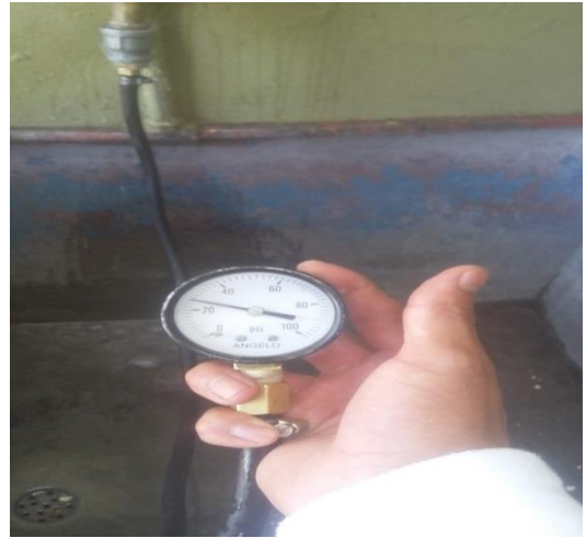
Medición de la Presión existente en la red a las 12:00 PM
