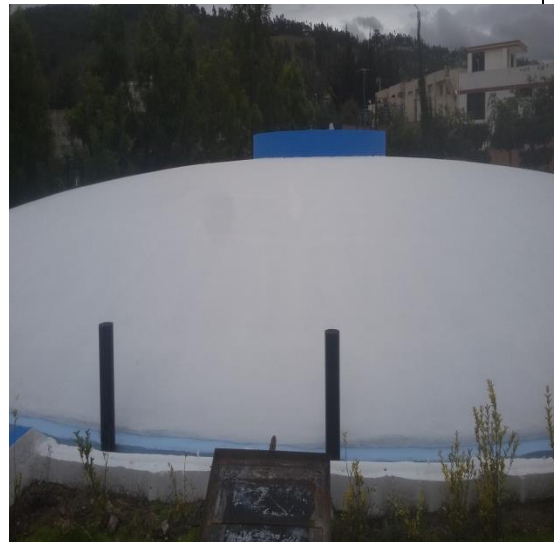
Tanque de almacenamiento circular “Panimboza” volumen= 2000 m 3 .
