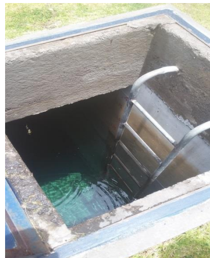
Tanque de almacenamiento cuadrado "Panimboza" volumen= 1000 m3.
