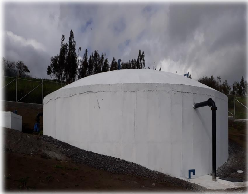
Tanque Reservorio de Benítez
