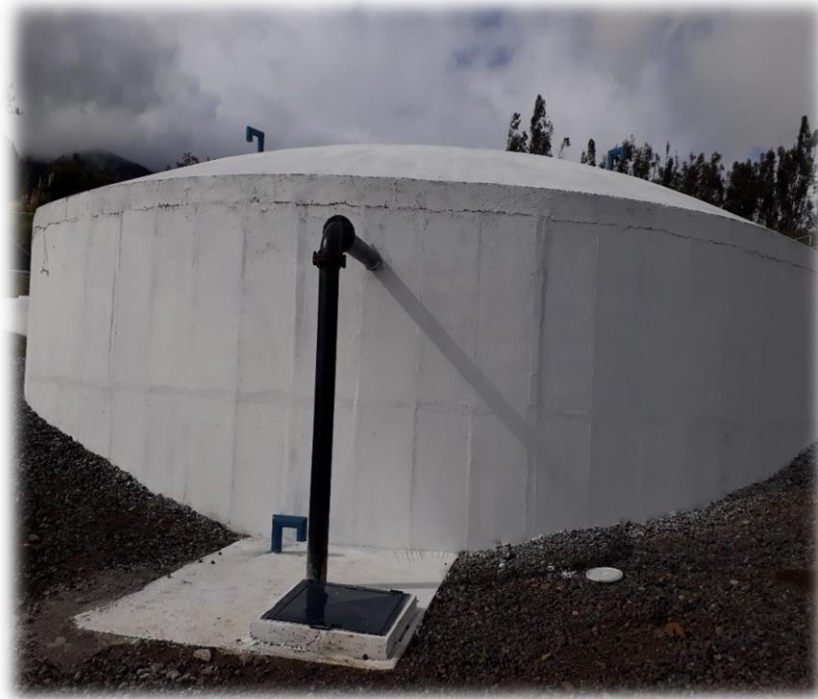
Salida del Tanque Reservorio
