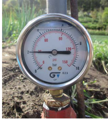
Figura 3. 17. Regulación de presión (Fuente: Autor)
