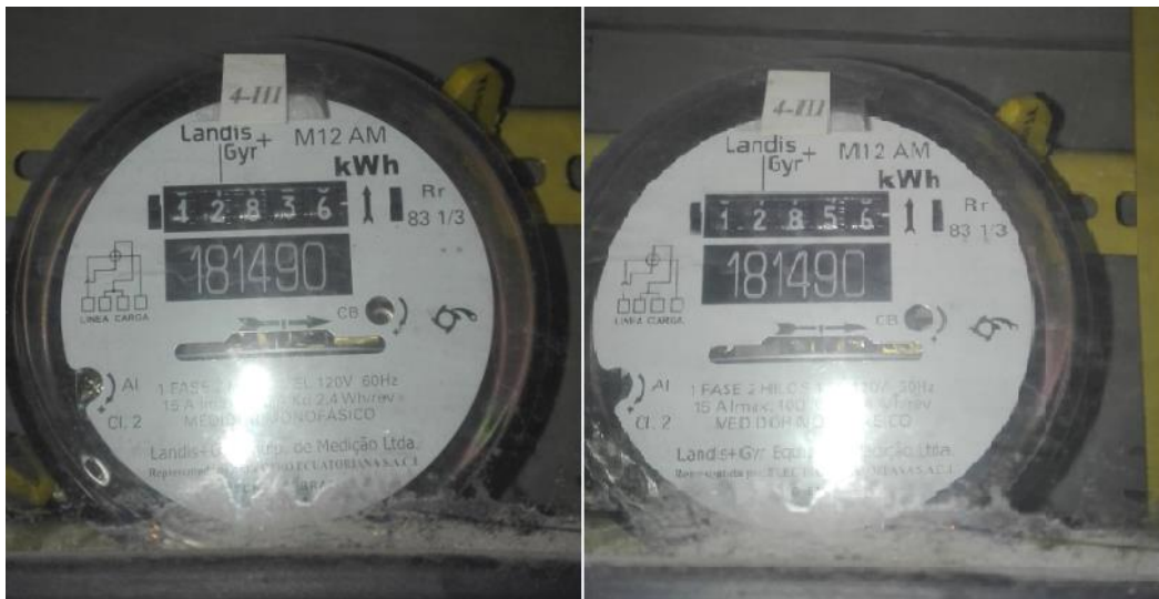
Figura 4.42 Lectura de los medidores de la Empresa Eléctrica Ambato S.A
