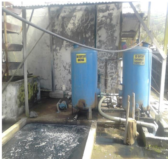
Filtros de arena y carbono activado, proceso principal de filtración del proceso de tratamiento de la empresa ROLAN's
