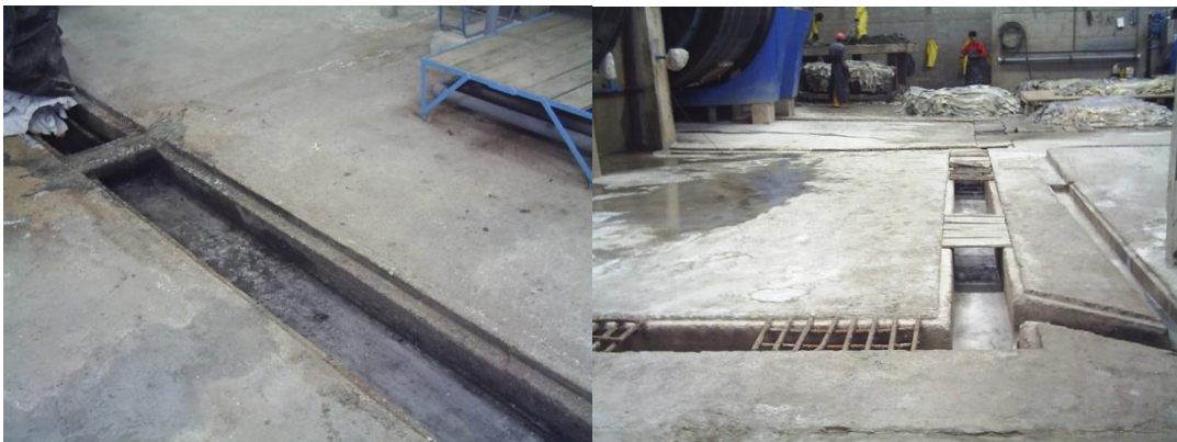
Canales de desagüe sin protección
