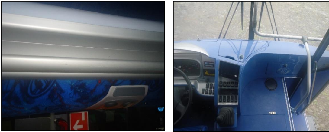
Fig. 35. Rayaduras en canastillas y cabina
