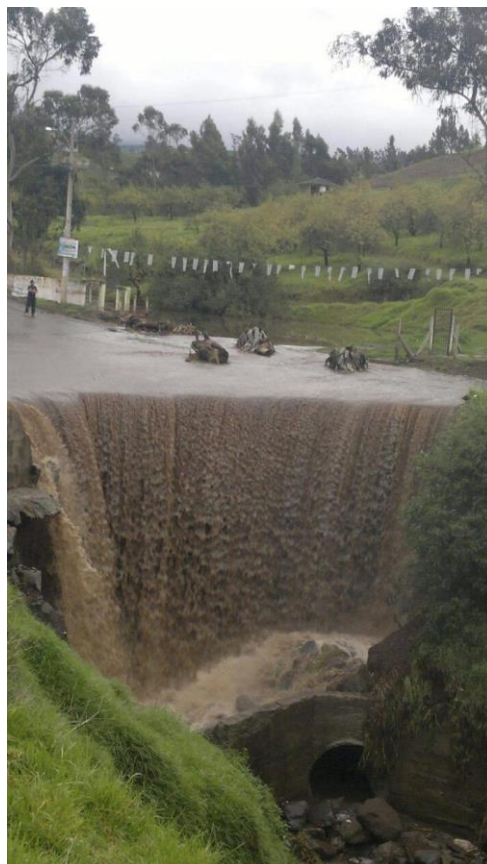
Lluvias- Quebrada Quillalli - Quisapincha
