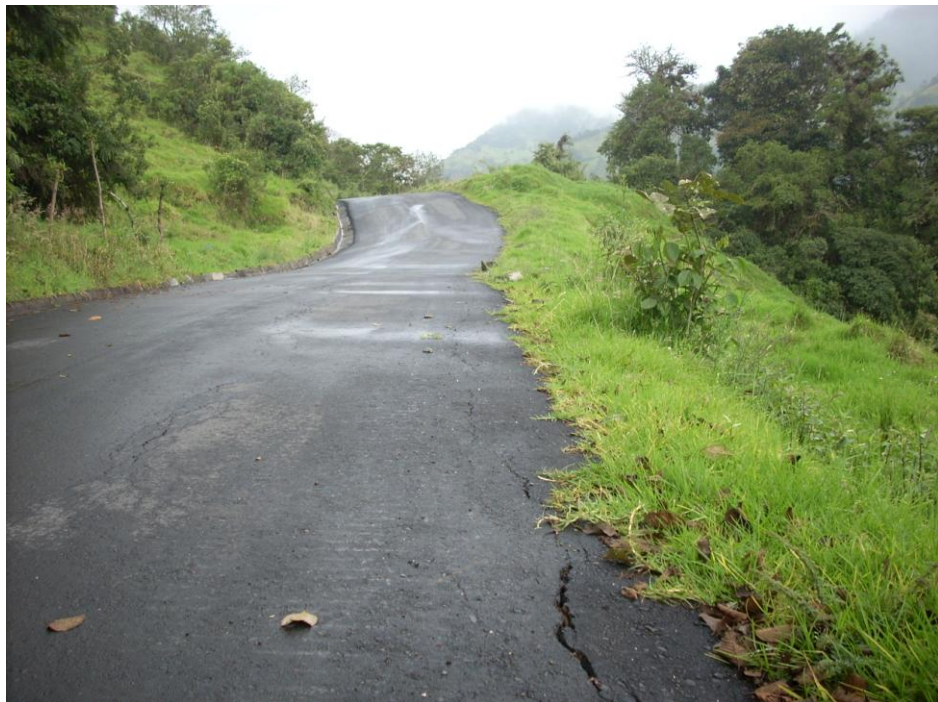
Fisuramiento de Borde
