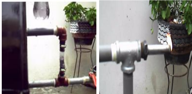
Medidor de nivel de carga en el tanque y funcionamiento
