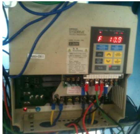
Figura 6.14: Variador de Frecuencia 363
