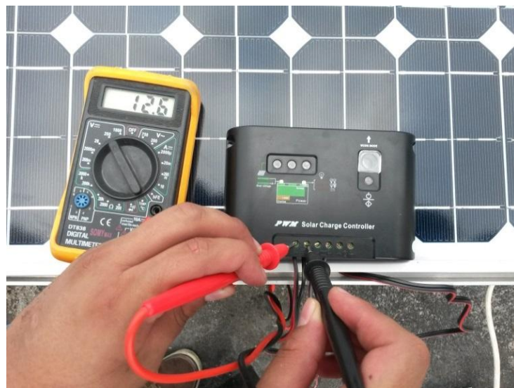
Fig. 4.41 Medida de voltaje de entrada del panel hacia el regulador Fuente: autor
