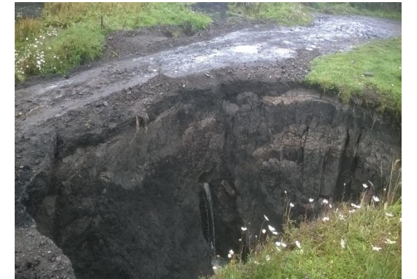
Ilustración 62: Vista posterior de la socavación
