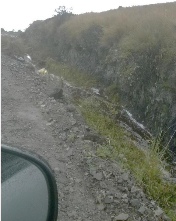
Ilustración 75: Socavación debido al canal de aguas
