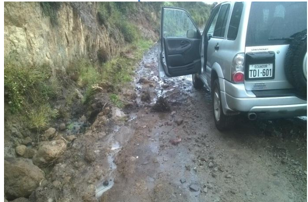
Ilustración 64: Daño de la vía por parte del agua
