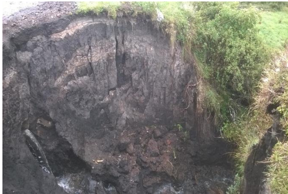
Ilustración 61: Socavación en un tramo de la vía
