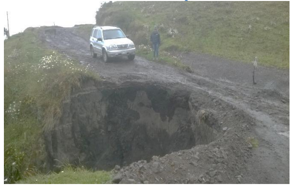
Ilustración 60: Deslizamiento de tierra
