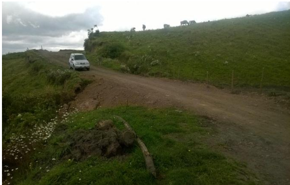
Ilustración 69: Vista del relleno realizado en la socavación
