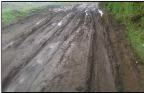
Vía en estudio luego de la lluvia
