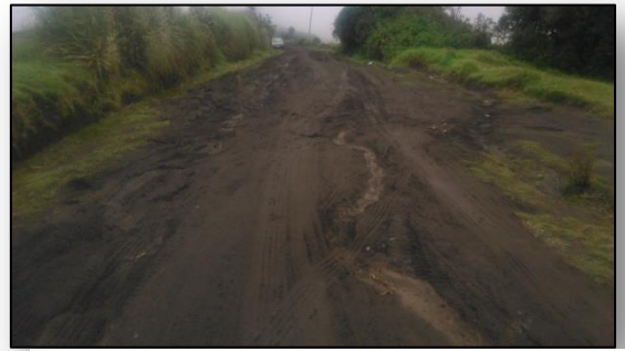
Superficie de rodadura deteriorada
